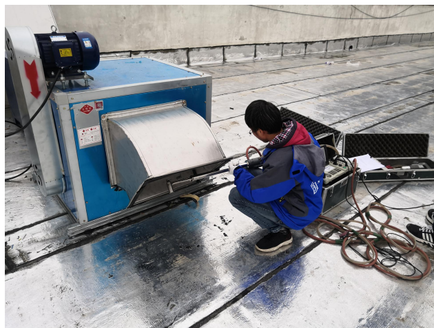
二楼油烟净化器出口
