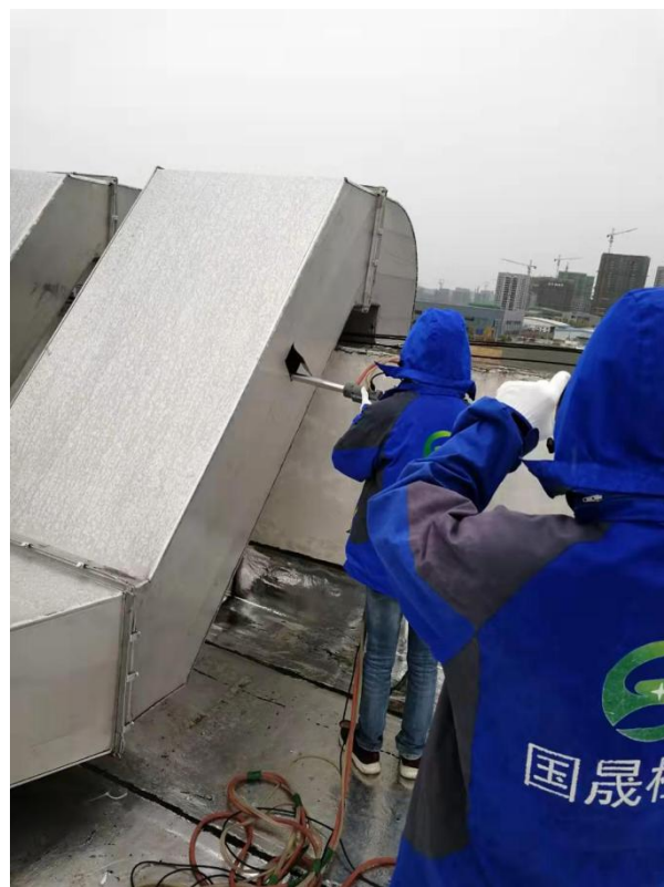
排气筒采样口
