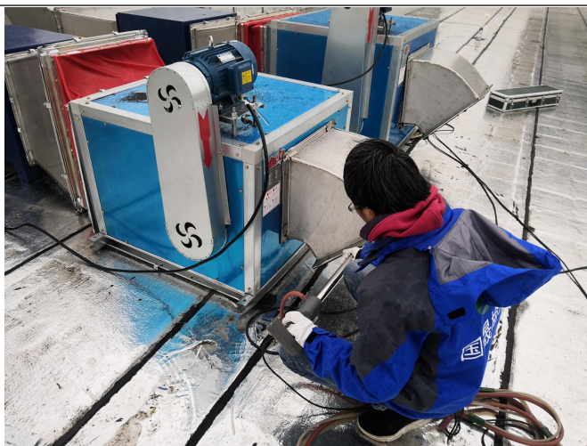
二楼油烟净化器出口
