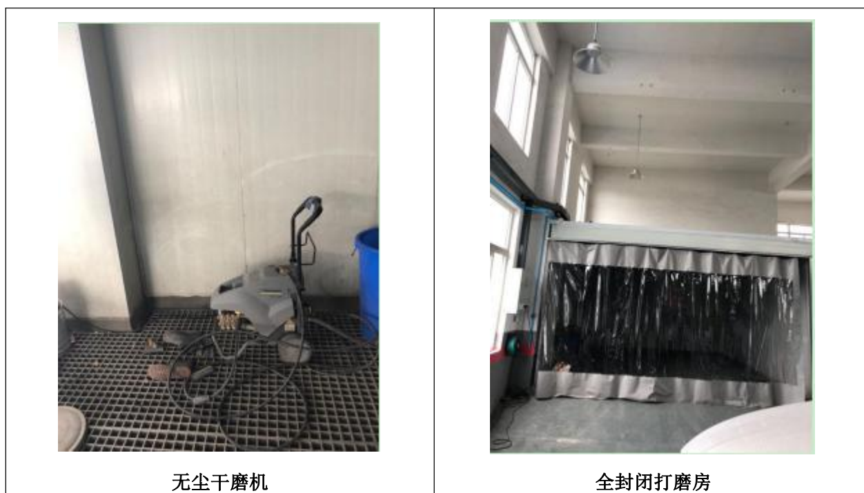
图4.1-4 打磨废气处理设施现场照片
