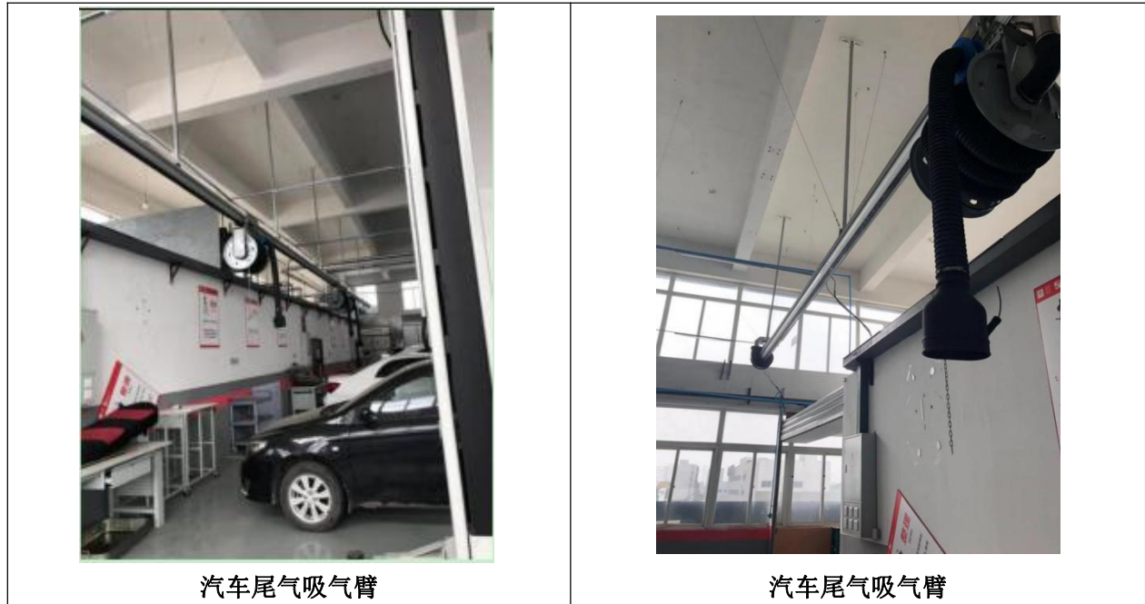
图4.1-7 汽车尾气废气收集设施现场照片
