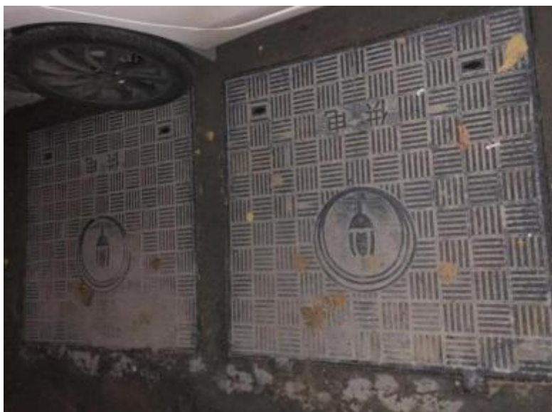
图4.1-1 隔油池、沉淀池
