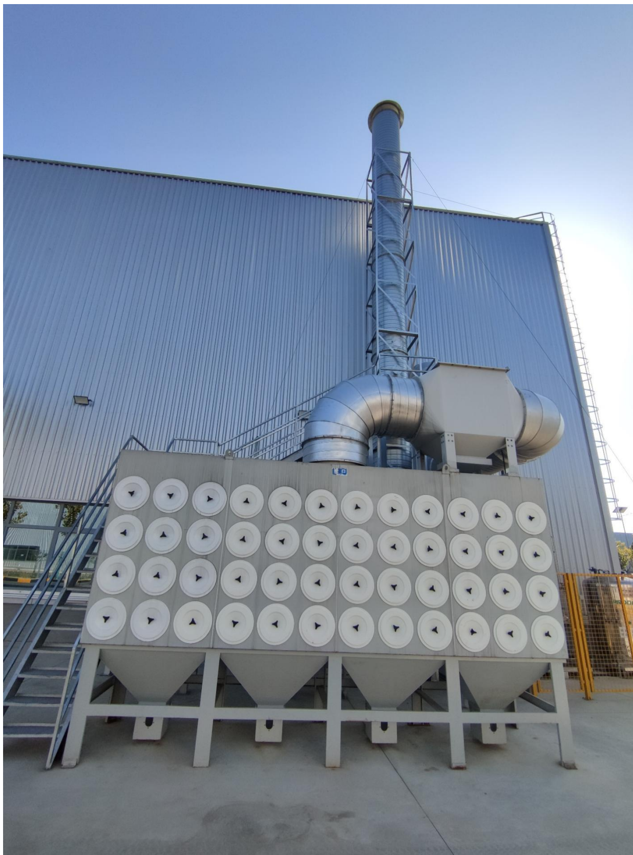
滤筒除尘器+DA001 排气筒
