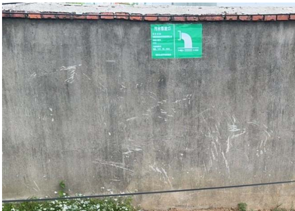
废水排放口环保标志牌
