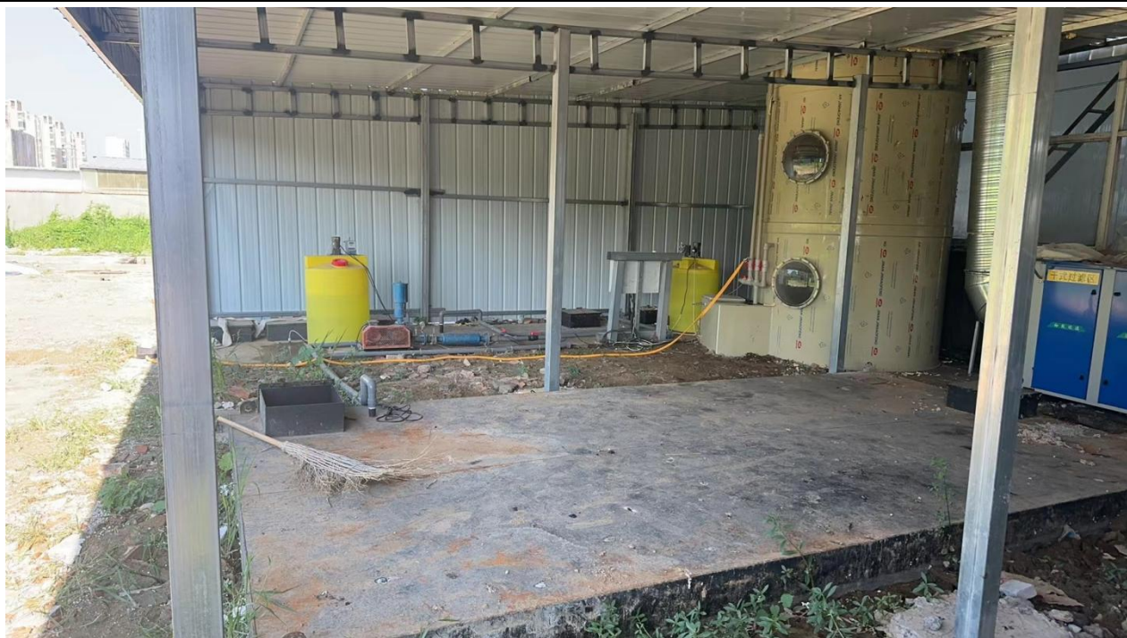
一体化污水处理站
