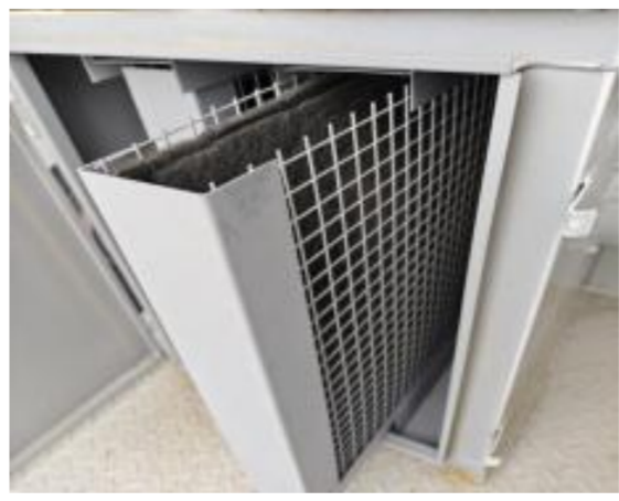
危废库配套废气处理装置
